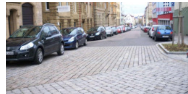
Vogelsangstraße / Ludwigstraße: Noch schlechter als vor dem Umbau; Kopfsteinpflaster mit Längsrillen
