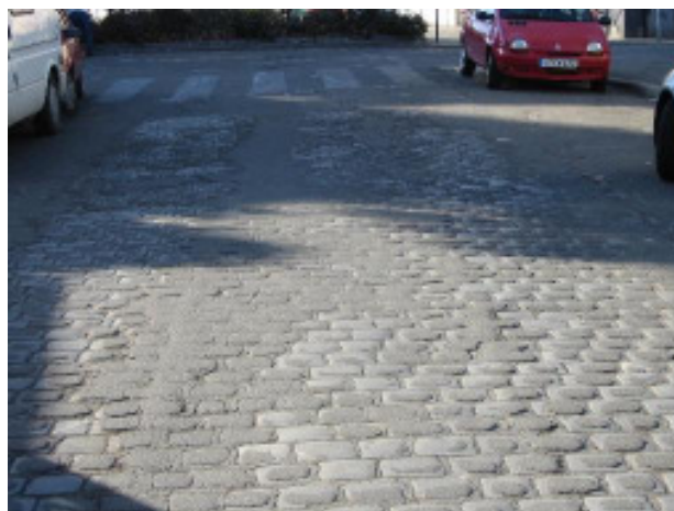
In der Haußmannstraße wurde der Belag schon einmal ausgebaut, inzwischen ist es zum Teil schlimmer als davor
