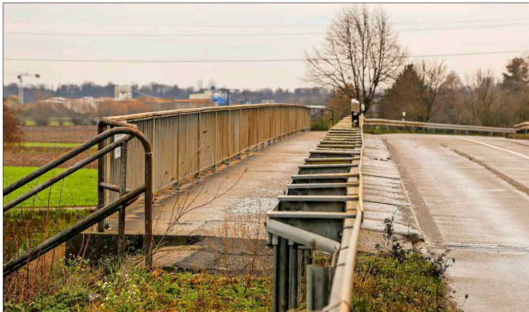
Die kritische Stelle für den neuen Radweg: Auf der Bahnbrücke müssen sich Radfahrer und Fußgänger die schmale Passage teilen (links), während daneben auf der Straße der Verkehr mit Tempo 70 rollt. FOTO: SANDRA DECOUX-KONE
