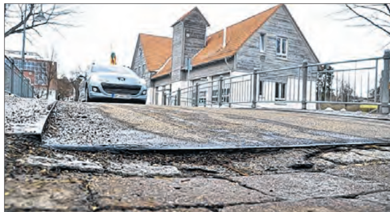
Der Pflasterbelag in der Brunnenstraße in Bartenbach ist arg ramponiert. Die Straße ist eine von 15, die jetzt erneuert werden sollen. Foto: Giacinto Carlucci
