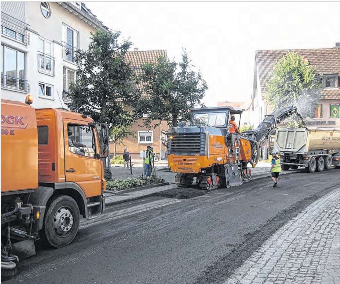
Die B 297 in Wäscheneuren wird wegen Belagsarbeiten zwei Tage lang voll gesperrt.
