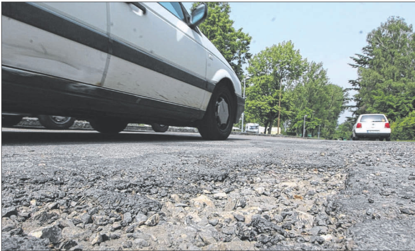
Schlaglöcher, Spurrillen, Unebenheiten: So manche Kreisstraße ist in einem schlechten Zustand. Der Landkreis will den Sanierungsstau schrittweise abbauen. In diesem Jahr werden rund 1,7 Millionen Euro in die Reparatur von Straßen gesteckt. Foto: Giacomo Carlucci
