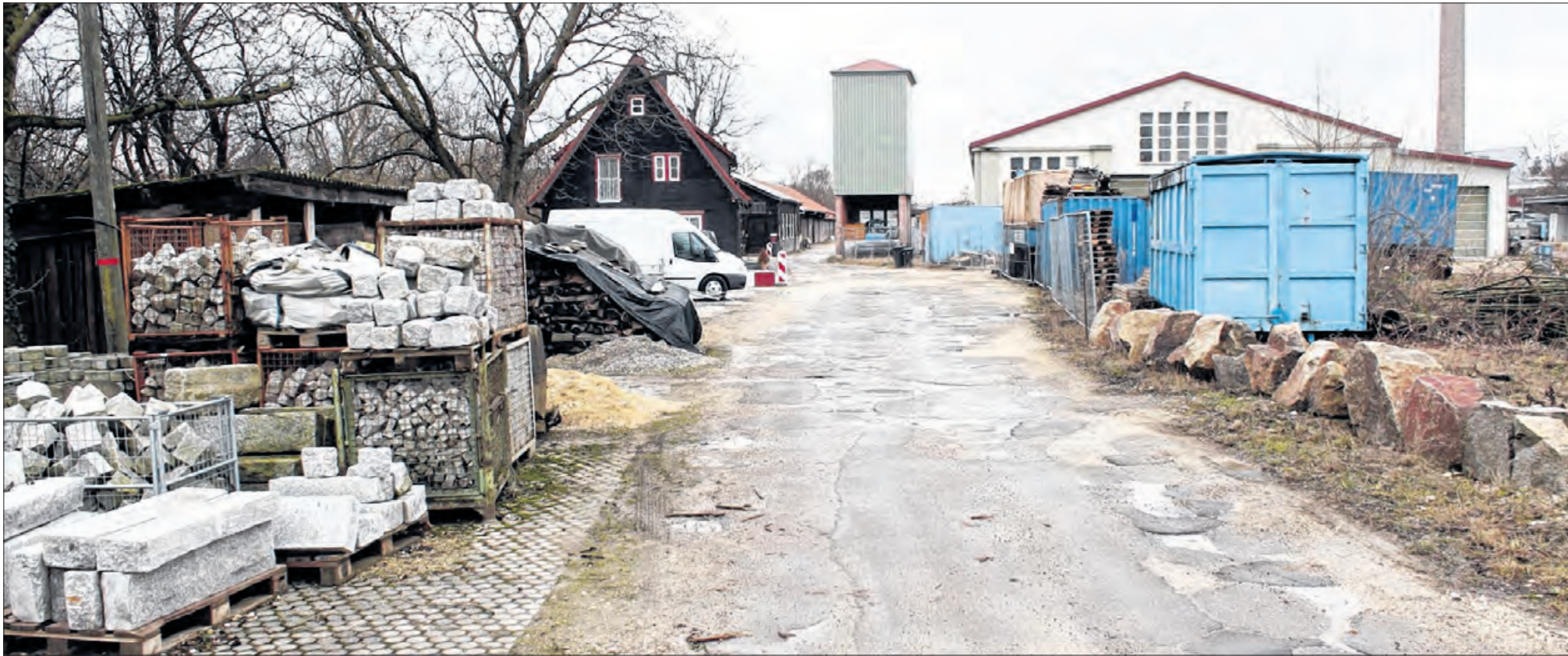
Die Filsstraße Eisingen ist in einem maroden Zustand, über ihre Sanierung wird schon seit Jahren geredet. Allerdings fanden Stadt und Anlieger bisher keine gemeinsame Lösung.
